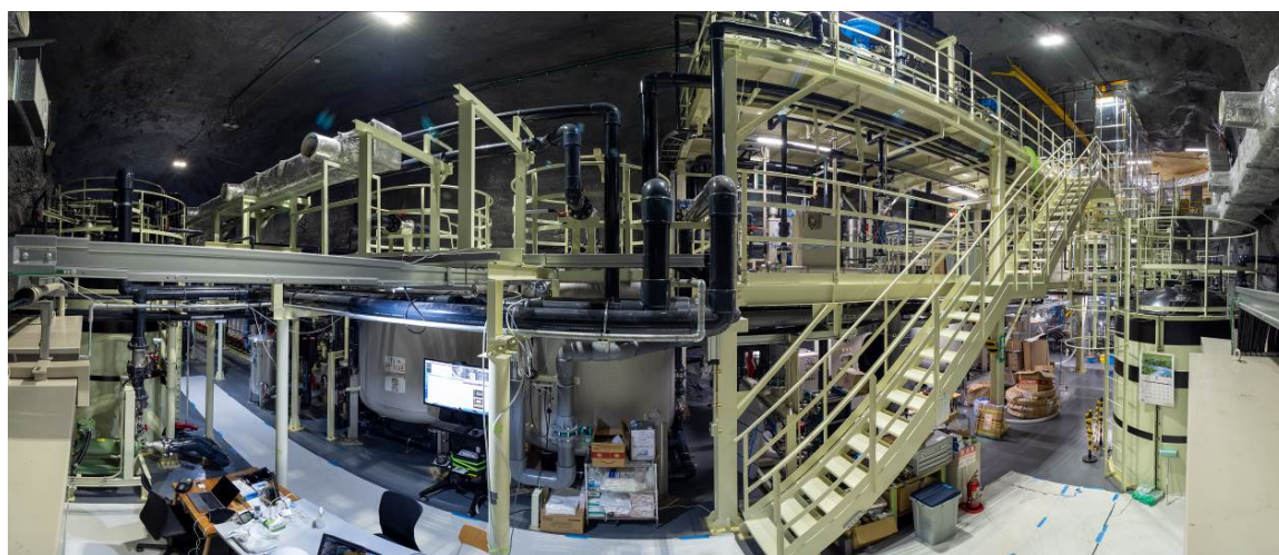
図5. ガドリニウム水システム
